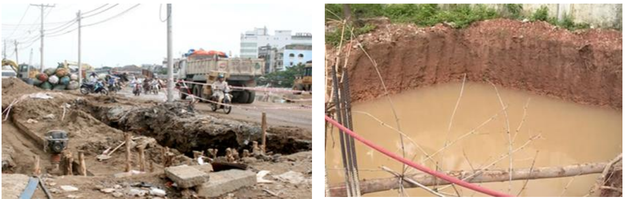
Ao, hố nước nơi công cộng không có rào chắn
